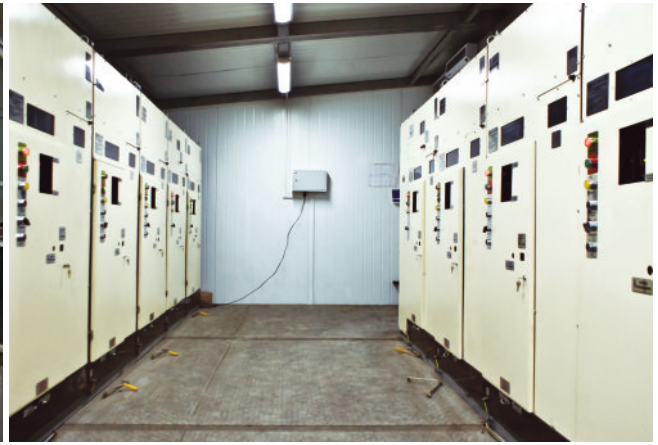
Распределительный пункт, собранный из КРУ-10 на шахте «Котинская» компании СУЭК
